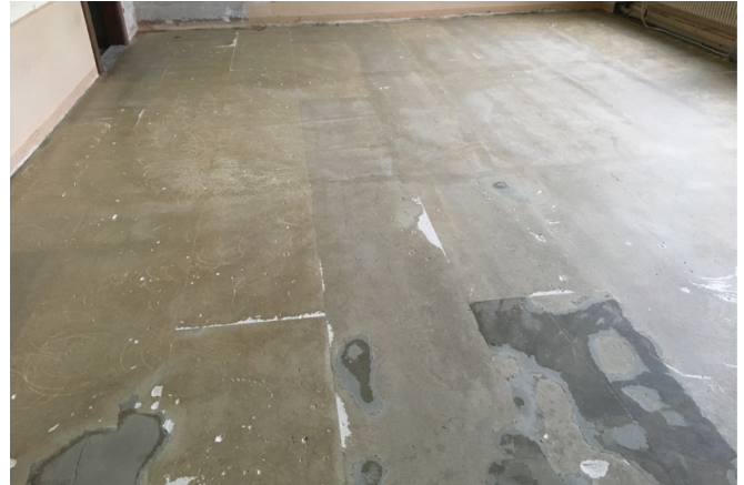
Ancien support nécessitant une réhabilitation.
